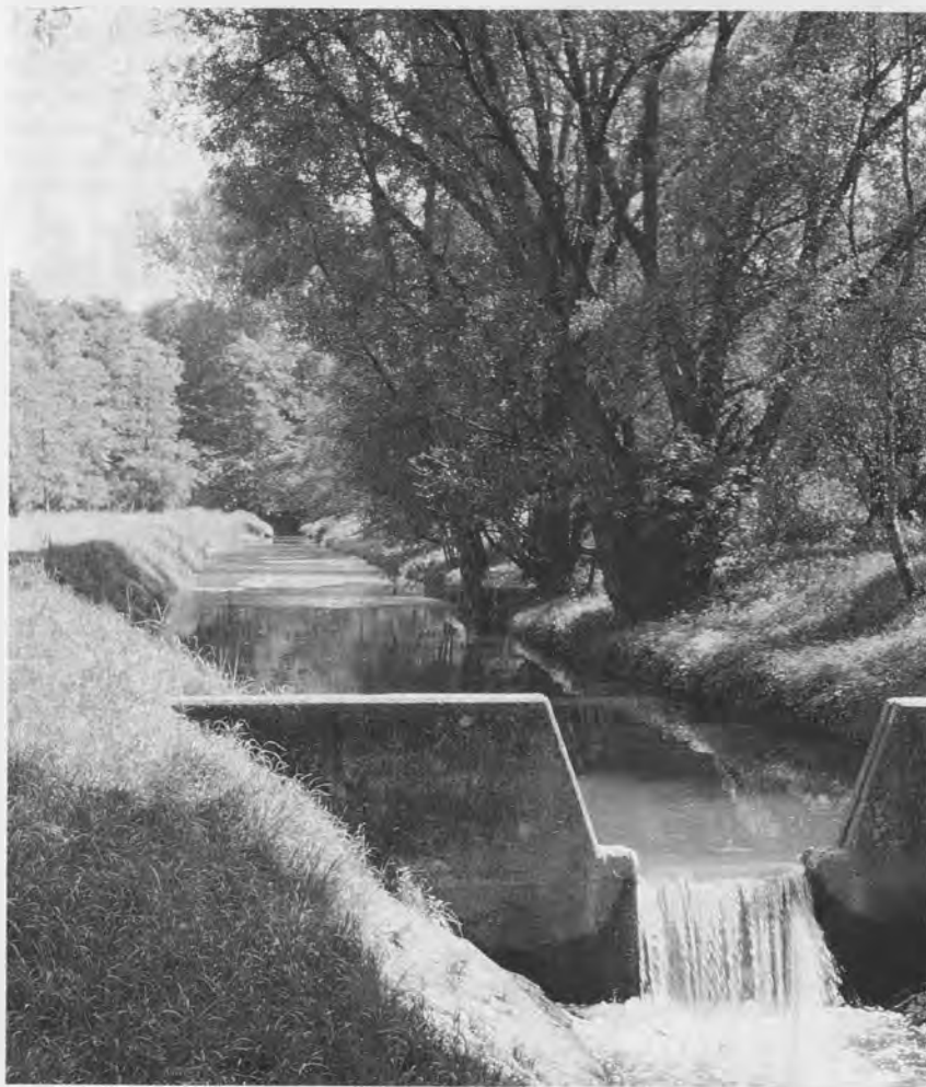
In Höhe der Rahmer Benden teilt ein Sandfang den Dickelsbach in zwei getrennte Abschnitte. Das Gewässerökosystem wird unterbrochen und durch die Bachbegradigung das angrenzende Niedermoor entwässert.
